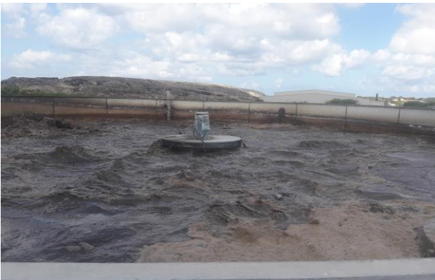
Sistema de tratamiento de agua (al fondo Parkietenbos)
