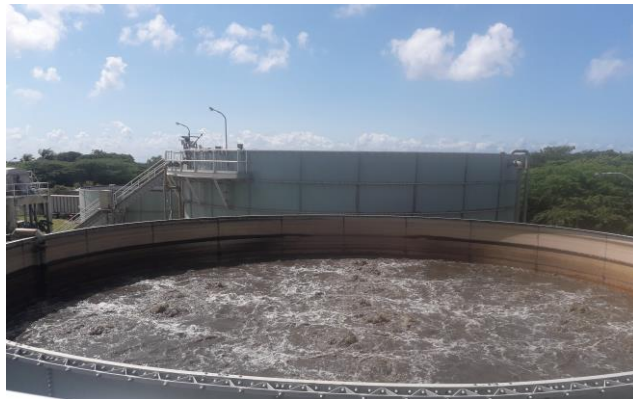
Sistema de tratamiento de agua (al fondo un sistema de tanque similar)
